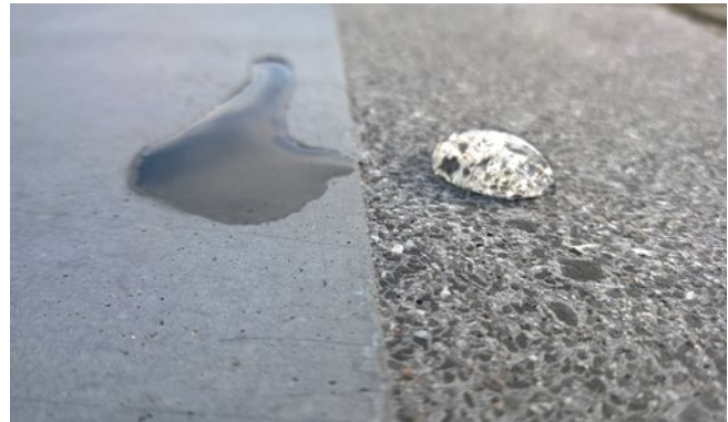
Links: Sichtbeton ungeschützt
